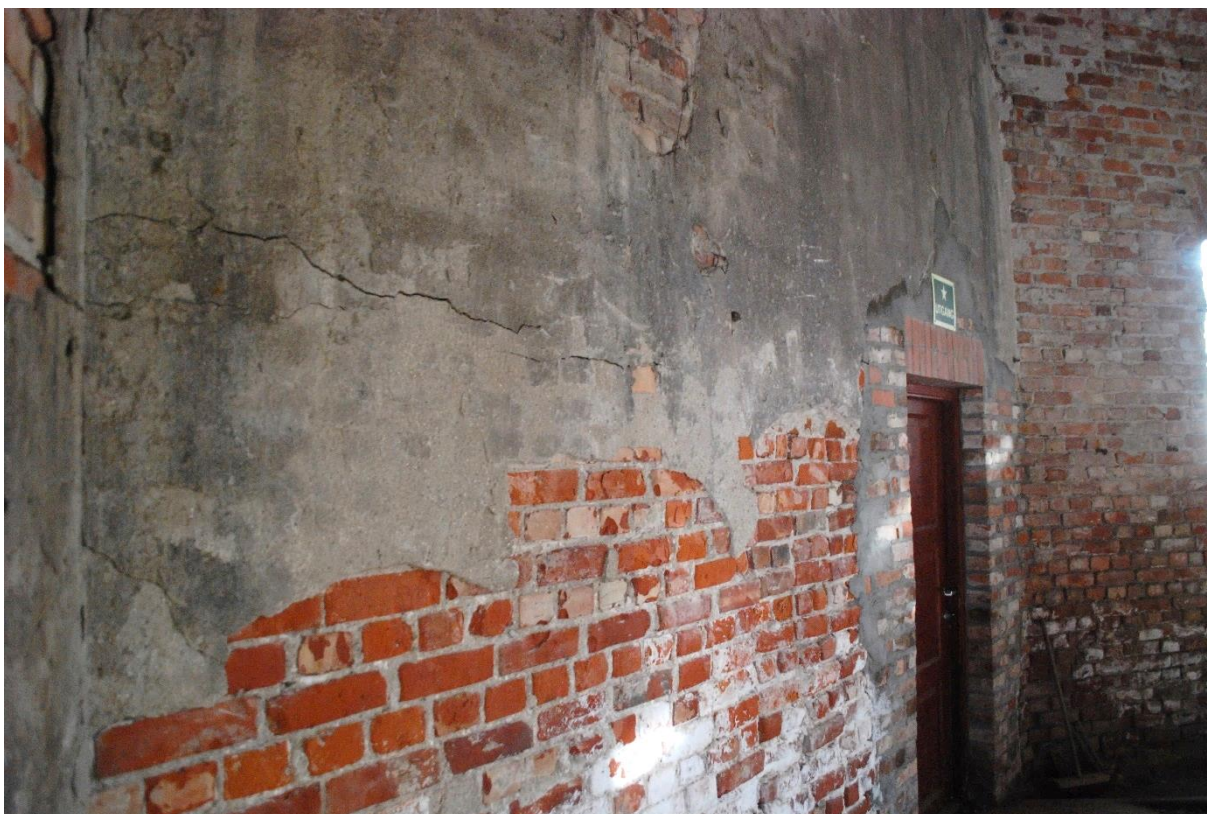
Rester av opprinnelig puss i det nordvestre hjørnet av Sodahuset. Det dreier seg om en enkel puss på kalkbasis, men mulig med en liten sementtilsetning. Pussen er godt bevart der det ikke er mye salt.
