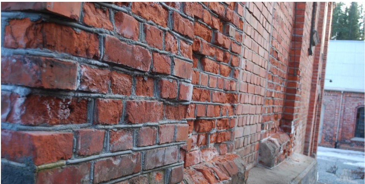
Massiv forvitring på Fyrhusets NV-hjørne. Salt er viktig her, men frost og tette sementfuger (KC 35/65) bidrar også. Dessuten blir fukten og saltet tvunget høyt opp i veggen av en betydelig påstøp med tett betong (i underkant av bildet). Videre gir takdrypp på hjørnet ekstra fuktbelastning. Legg forøvrig merke til at teglsteinene har ulik grad av forvitring. Dette skyldes nok vekslende kvalitet, spesielt knyttet til porøsitet og porestruktur.
