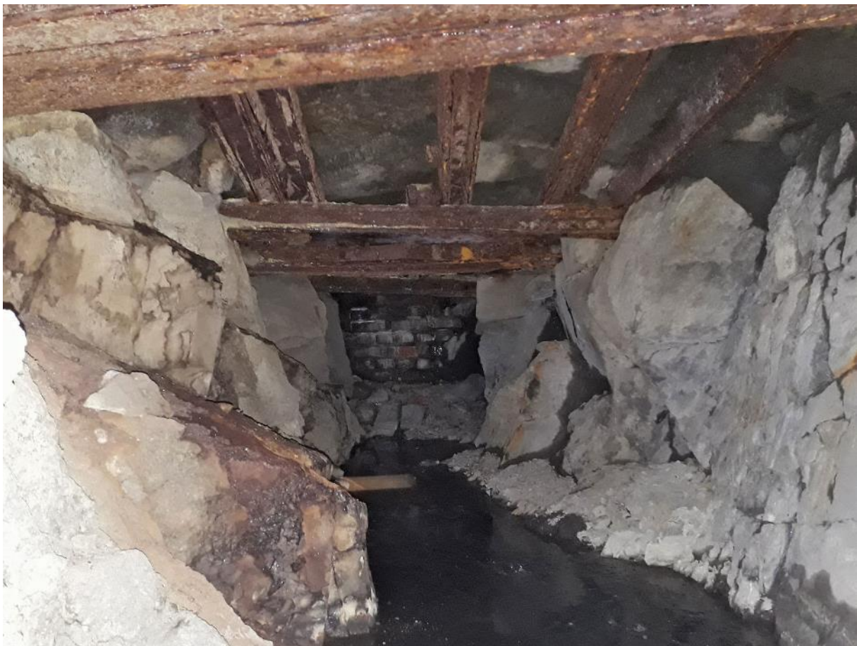
Utsprengt kanal med sulfatholdig vann fra det utsprengte området for grønnluttanken under sodaovnene. Kanalen fortsetter i rør utenfor fundamentene/veggene.
