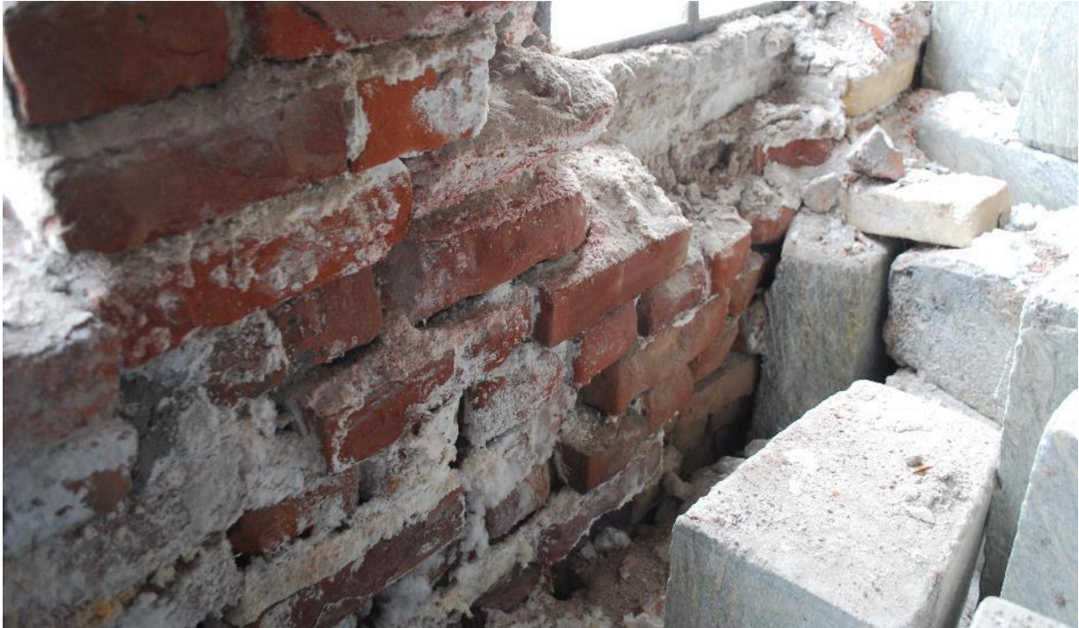
Massiv saltforvitring som spesielt angriper opprinnelige, kalkbaserte fuger. Inne i Sodahuset, NØ-vegg.
