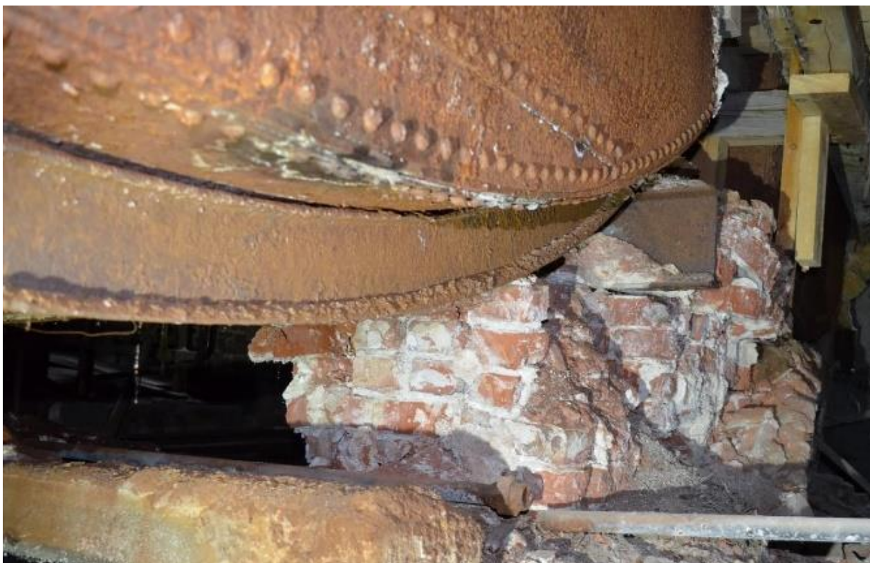
Alvorlige forvitringsskader og setninger i fundament for silkar vest i Luthuset. Foto: Anno Museum.
