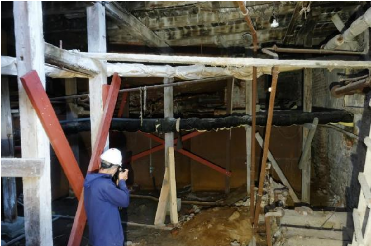
Midlertidige sikringstiltak for det sørvestre silkaret i Luthuset etter at det ene fundamentet ga etter.
