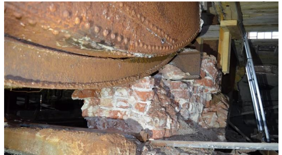
Fra ett av fundamentene under silkarene vist på bildet over. Mørtel og teglstein har så store forvitringsskader at det er fare for at fundamentet kollapser.
