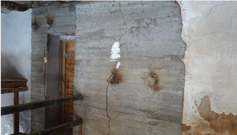
Påstøp for å sikre øvre del av norvegg (over Remkanalen). Påstøpen har sprukket opp og utviklingen blir overvåket vha. gipsplomber. Utv. er det vertikal sprekk i teglmuren.
