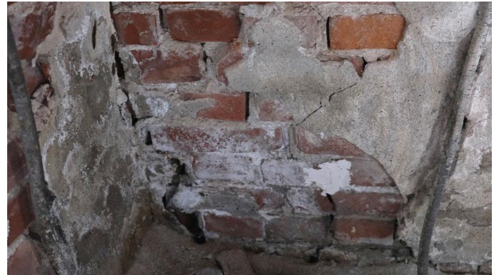
Innvendig i samme hjørne. Vertikale sprekker, trolig fra perioden før 1995. Vår 2021 ble det satt flere gipsplomber i hjørnet for å overvåke situasjonen.
