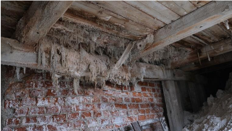
Store lutskader i golv ved søndre miksekar.
