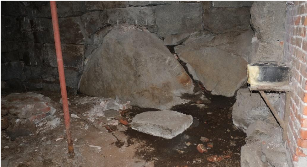
Fra kjelleren i Hoggeriet, som viser fuktig grunn i samme hjørne i nordøst.
