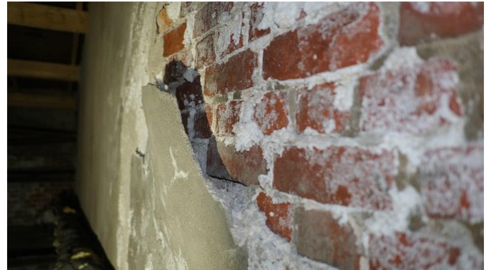
Fra samme del av sørvegg mot Remkanalen. Sementpuss som sprekker opp og flaker av som følge av salt- og frostforvitring.
