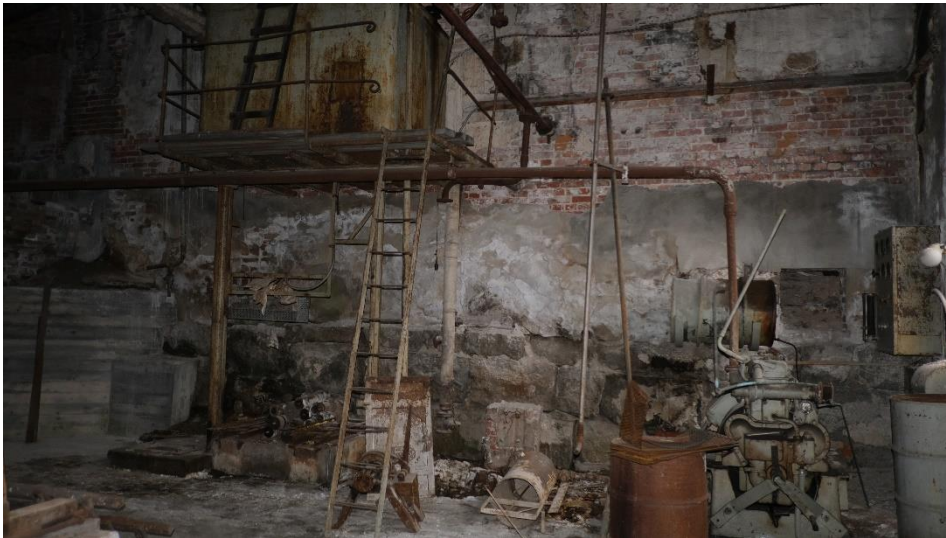
Nedre og søndre deler av vestvegg sett fra Fyrhuset. Veggen har alvorlige skader pga. salt- og frostforvitring.
