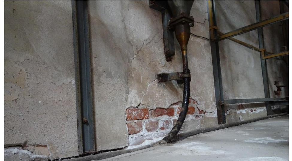
Parti av golv og delevegg i traferommet. Salt- og frostforvitring har ført til sprekker og bom i sementpuss på vegg.
