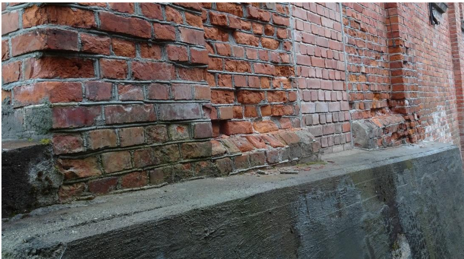
Sterkt forvitret murverk over påstøp på nordvestre hjørne.
