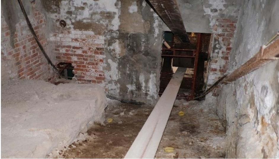
Fra vestre ende i Remkanalen, fuktig grunn og omfattende salt- og frostforvitring i vegger. Til høyre åpning til maskinrommet.
