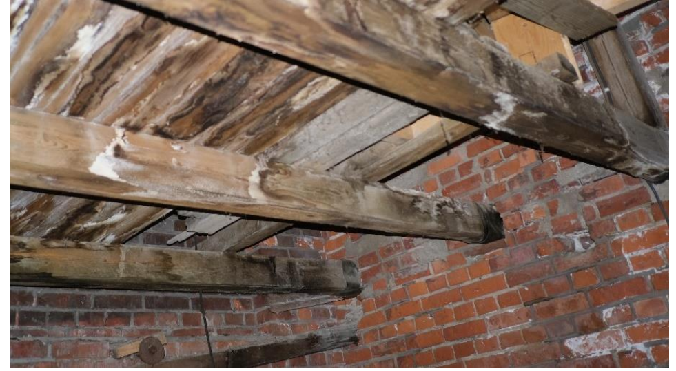
Fra østre ende i kanalen med deler av golv i gangen mellom Kokeriet og Luthuset. Det er fuktskader i bjelker og i borddekke.
