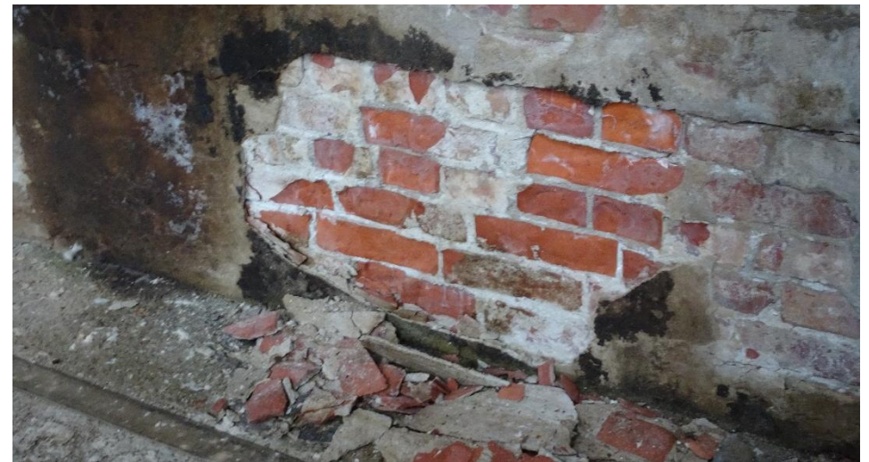
Skader etter salt- og frostforvitring i teglfundament for papirmaskinen. Ekstra store skader fordi det er pusset med "tett" sementmørtel eller en sterk kc-mørtel.
