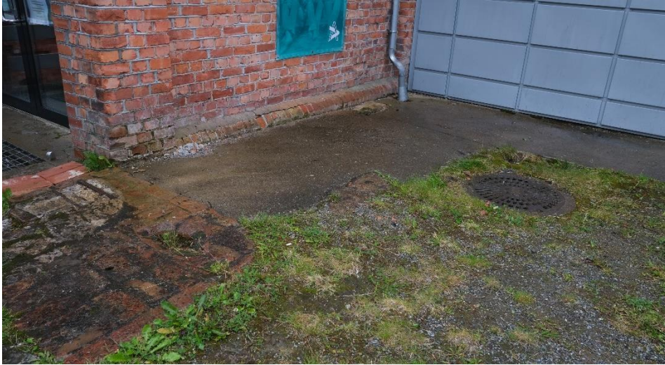
Fra området ved hovedinngangen til museet der terreng- og dreneringsforholdene bør utbedres innen kort tid.
