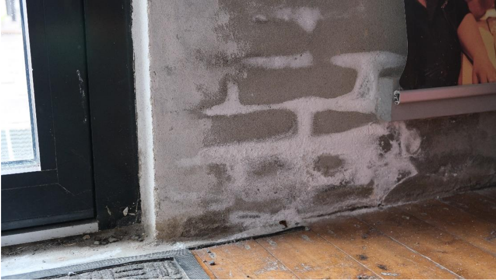
Det er lignende skader i pusset teglvegg på andre siden av inngangsdøra.
