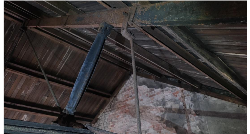
Rustskader i takkonstruksjoner, mest som tynt overflatesjikt. Konstruksjonen har sjeldne trykkstag i støpejern.
