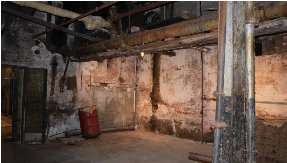
Fra Turbinhallen sett mot vegger til Papirmaskinsalen, Kokeriet og Hoggeriet, vegger med betydelig salt- og frostforvitring.
