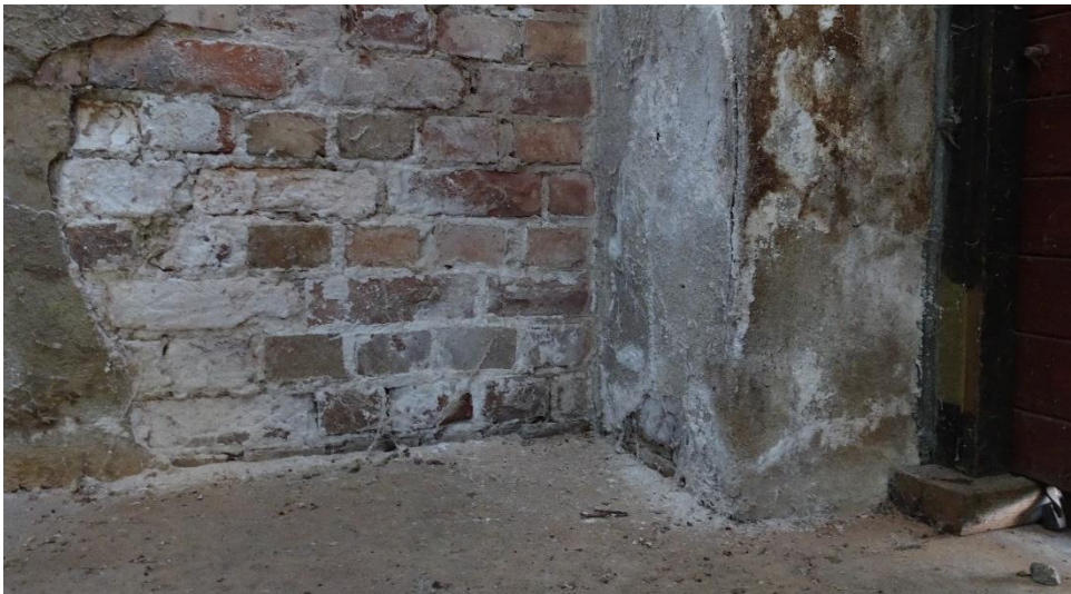
Skader etter salt- og frostforvitring i vegger nederst i hjørne mot sørvest.
