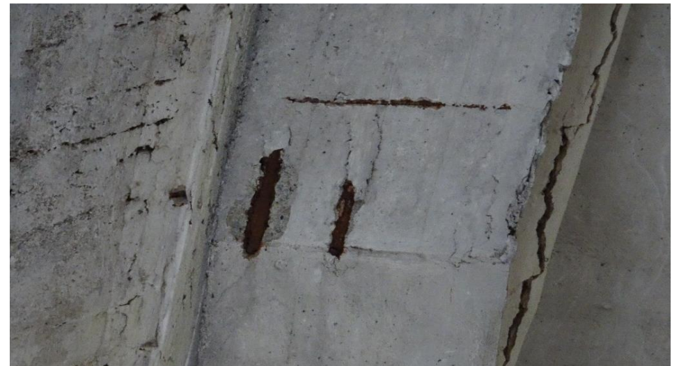
Detalj i tak i maskinhallen, ett av flere små felt med synlig armeringsstål som rustet, betong sprekker opp og løsner. Skadeomfanget øker.
