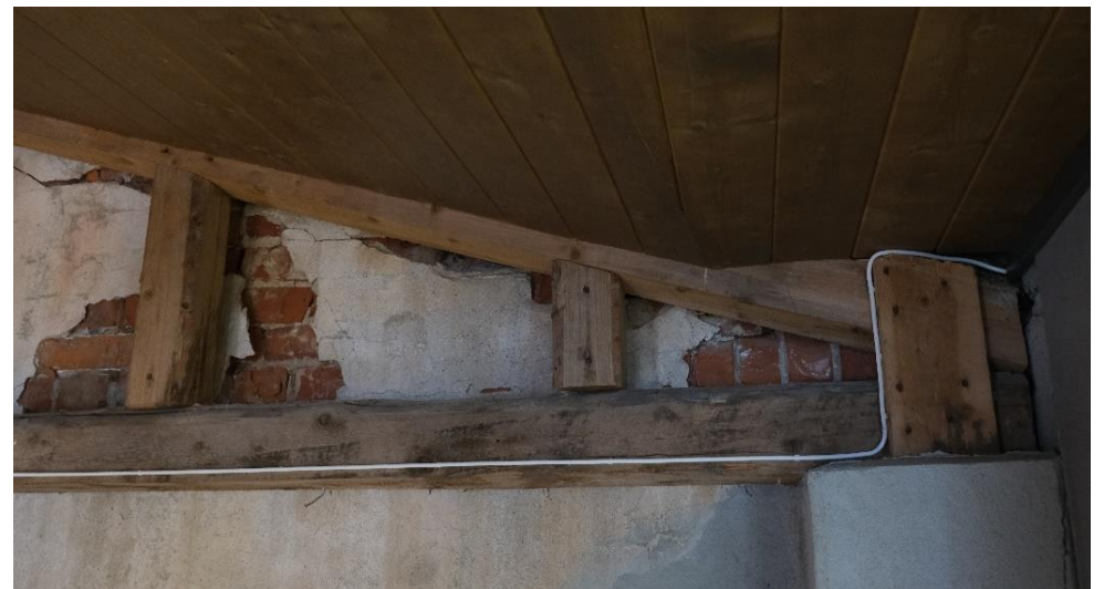
Skader øverst i vegg mot Kokeriet, ved hjørne i nordvest (mot Kokeriet).
