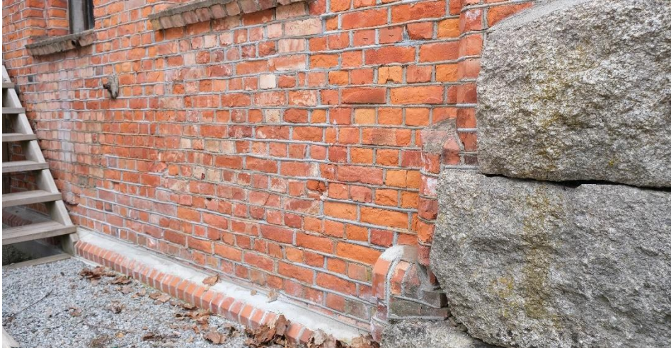
Fra hjørne mot sørøst. Eksempel på parti av ytttermur som har betydelige forvitringsskader i tegl og dels i fuger. Tegl trekker til seg fukt, blir utsatt for frost og sprekker opp, som tynne flak eller i større deler.
