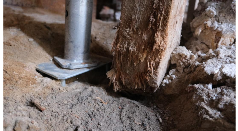
Bærepunkt i kjelleren som er sikret med et stålstag ettet brudd i betongfundament og råte nederst i trestolpe.
