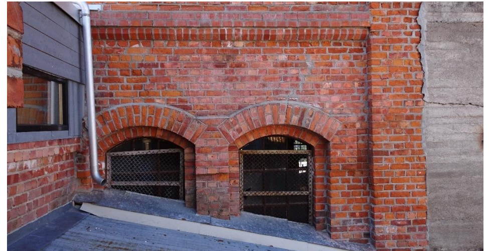
Eksempel på parti av taktekingen der det er lekkasjer i kanter mot vegg til Kokeriet.
