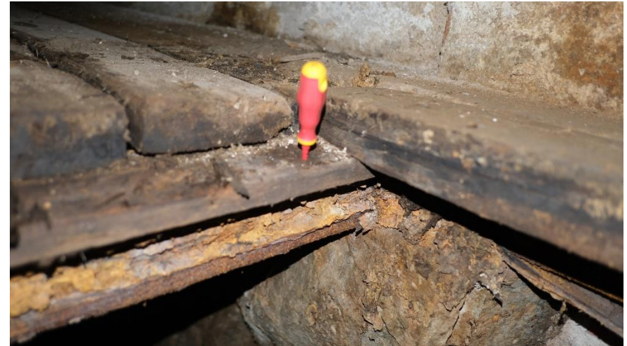
Råteskader i plankedekke i nordøstre del av Turbinhallen, samt rustflak i flere sjikt i stålbjelke.
