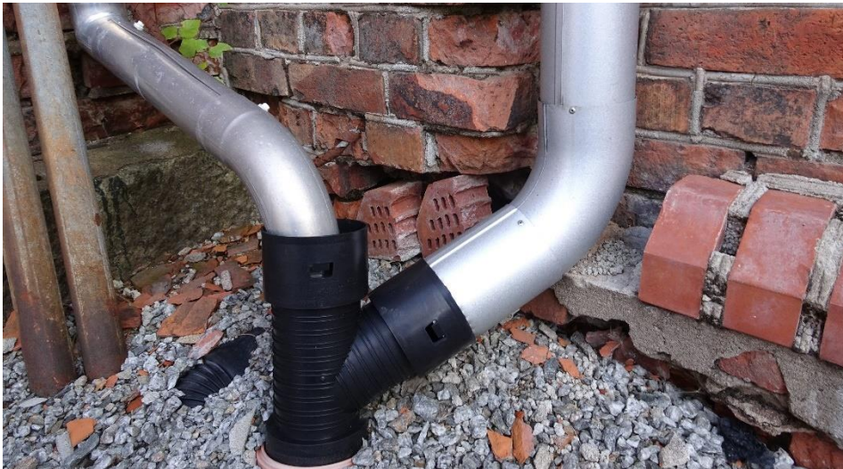
Ved hjørne mot nordvest, med gamle og nye forvitringsskader i tegl og fuger. I nymurt smitegl (2012) på bildet og videre sørover er det allerede dype skader i fuger.
