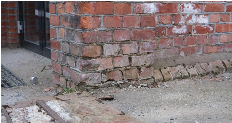
Betydelige forvitringsskader i teglstein og fuger i nedre deler av yttervegg på samme sted.
