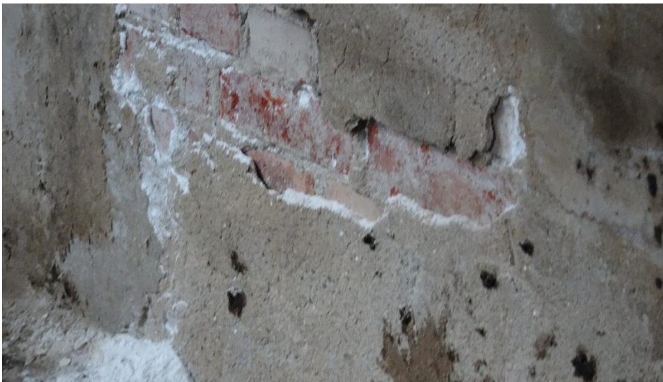
Typisk situasjon ved innerliv til nordvegg med salt som krystalliserer og sprenger slik at sementpuss mister heft.
