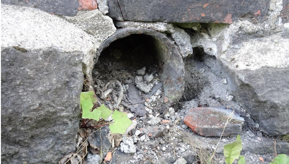
Eksempel på lufteør i støpejern gjennom grunnmur som delvis er tettet med diverse løsmasser, her fra vestsiden av bygningen.
