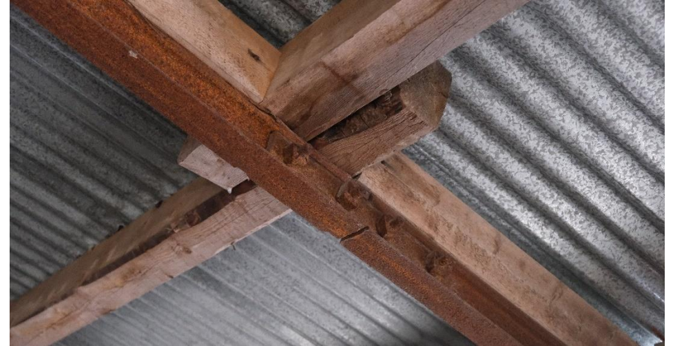
Eksempel på skjøt mellom stålbejler i tak som har begrenset bæreevne.
