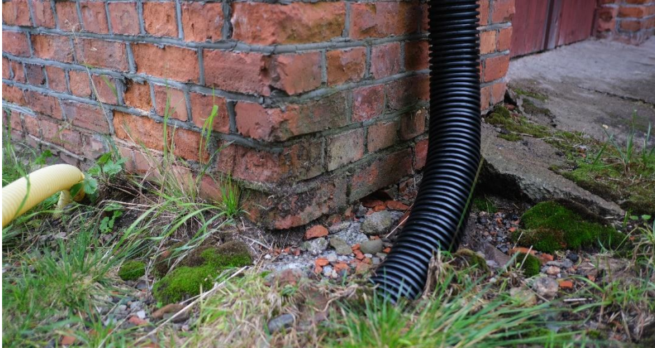
Terreng som står høyt på hjørne mot sørøst, samtidig vann fra taknedløp, med store forvitringsskader i et avgrenset parti som resultat.
