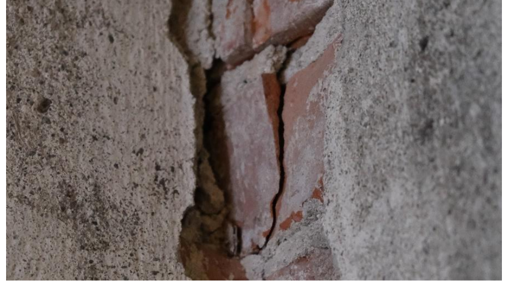
Eksempel på andre skader i teglvegger, her fra hjørne innvendig i sørvest (mot Kokeriet).
