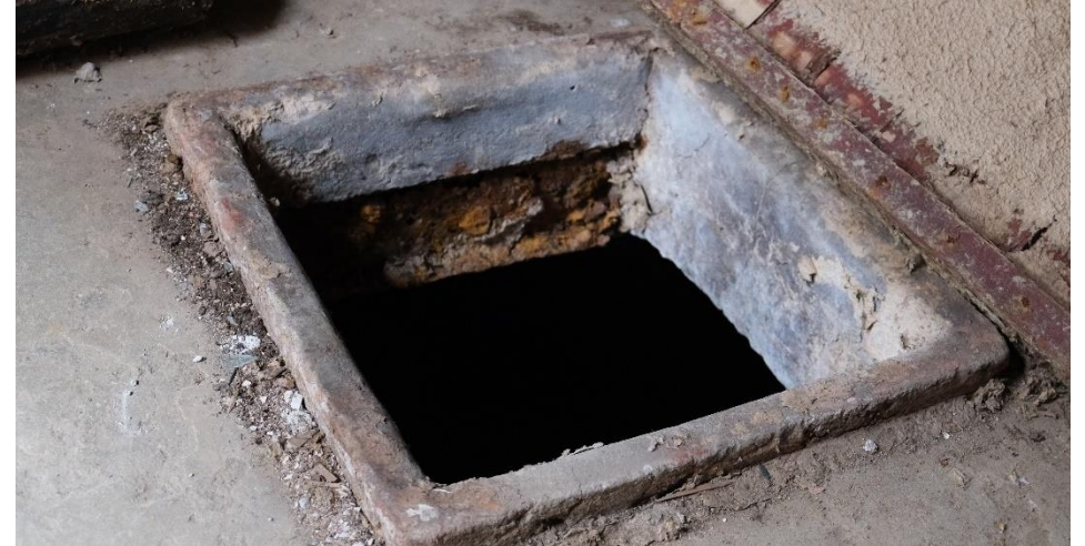
Fra luke i golv der steget i stålbelken inntil åpningen har gjennomgående rustskader.
