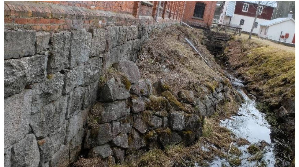
Del av forstøtningsmuren mot utløpskanalen på sørsiden av pakkeribygningen har store setningsskader.
