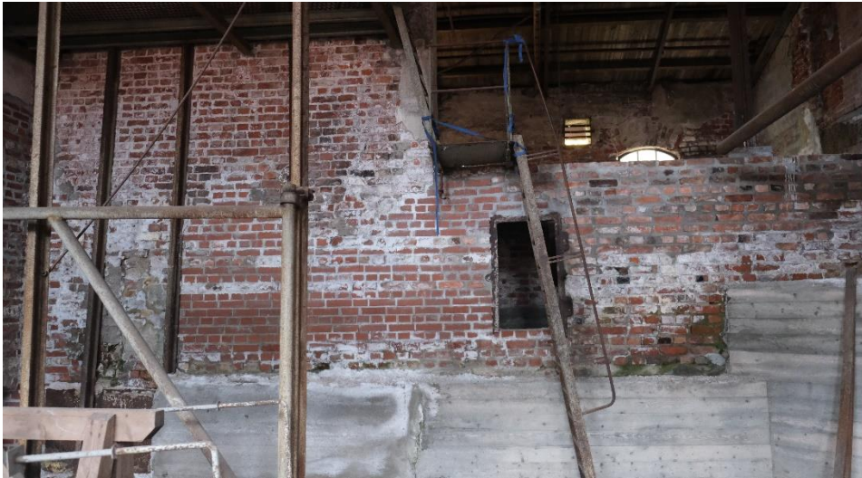
Ovnsvegg og del av pipeløp gjennom Fyrhuset som også har omfattende forvitringsskader I alle nivåer, også i betongsikringen ved golv.
