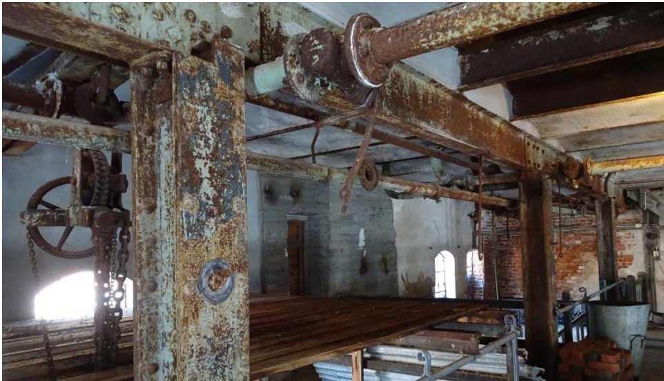
Typisk situasjon for stål i bygningen, med omfattende over overflatekorrosjon i søyler, bjelker, rør, ulike koblinger m.m.
